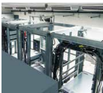
Camere de server
