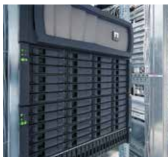
Incinte pentru telecomunicații
